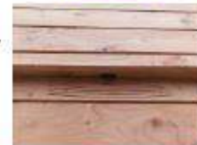
Gîtes à chiroptères Intégrés dans le bâti (8 gîtes au total)
