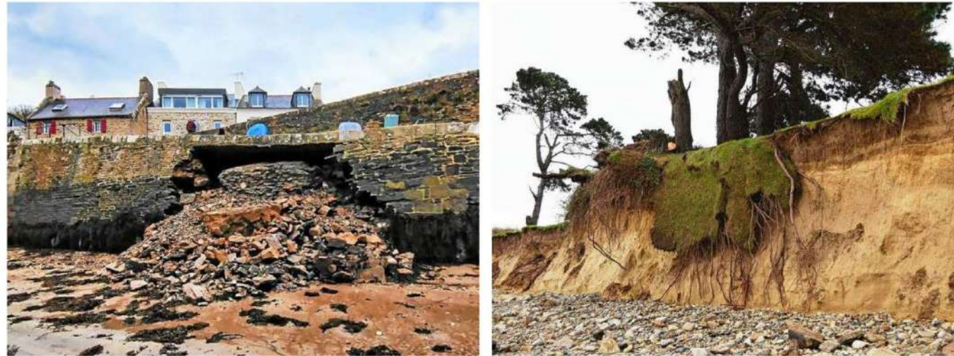
Dégâts engendrés par les tempêtes Céline et Ciarán au Conquet (29) sur une digue appartenant à la Région et à Saint-Pierre-Quiberon (56) [Source : Le Télégramme]
